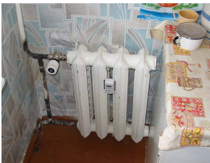
Рис.1. Термостатический регулятор «Данфосс» и радиаторный распределитель тепла в квартире в г. Белоречке
