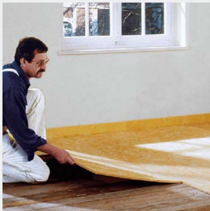
Изоляция из минеральной ваты укладывается встык с изоляционной кромочной лентой и далее ряд за рядом без промежутков
