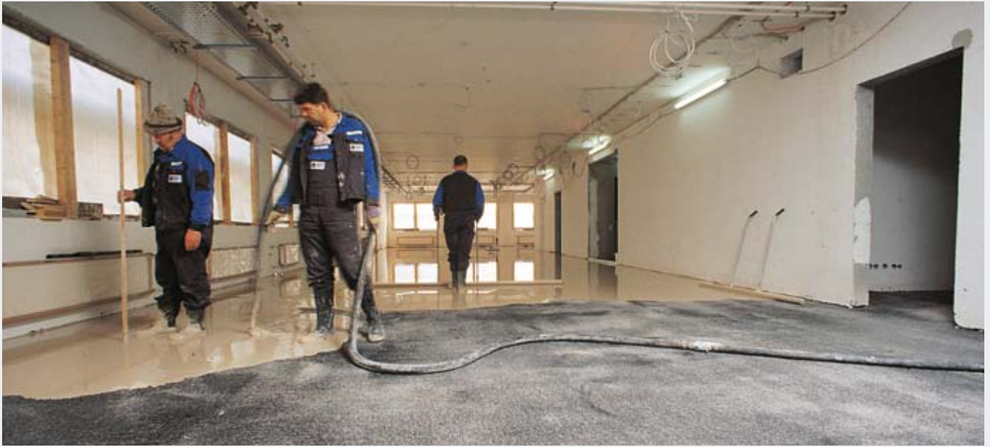
Укладка самовыравнивающегося наливного пола КНАУФ Нивелирэстрих 425 на большой площади на герметик КНАУФ FE-Abdichtung
