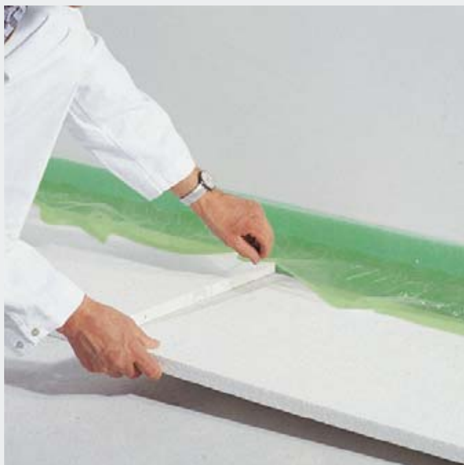
Изоляцию из пенополистирола уложить под пленку изоляционной кромочной ленты и укладывать ряд за рядом без промежутков
