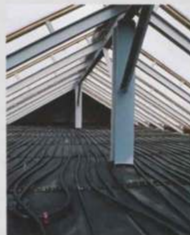
↑ Черные трубы на чердаке – поглотители энергии
