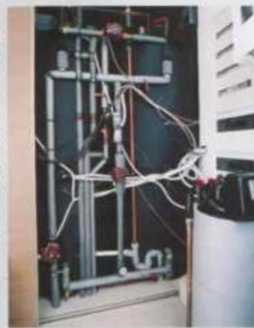
↑ Резервуары, аккумулирующие тепло для отопления дома
