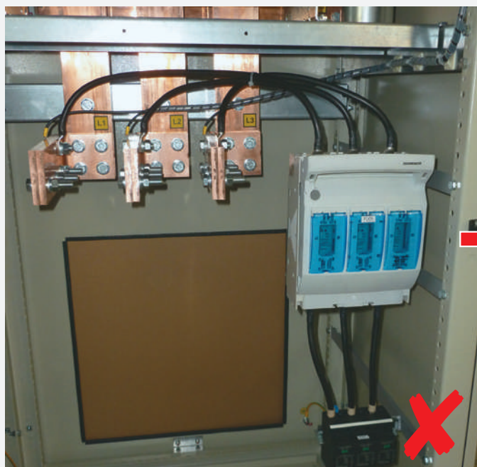
До изменений: способ установки УЗИП-а не выполняет предъявляемых к проводам подключения УЗИП-а требований по длине.
