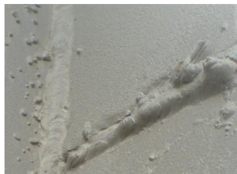
Рисунок 9.8. – Дефектный сварной шов, на котором присутствуют подрезы, неровности и сварные брызги.
