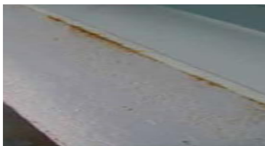
Рисунок 9.16. – Ржавление кромок двутавровой балки.
