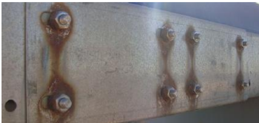
Рисунок 9.15. – Разрушение цинка на оцинкованных стальных листах, соединенных болтами из нержавеющей стали.
