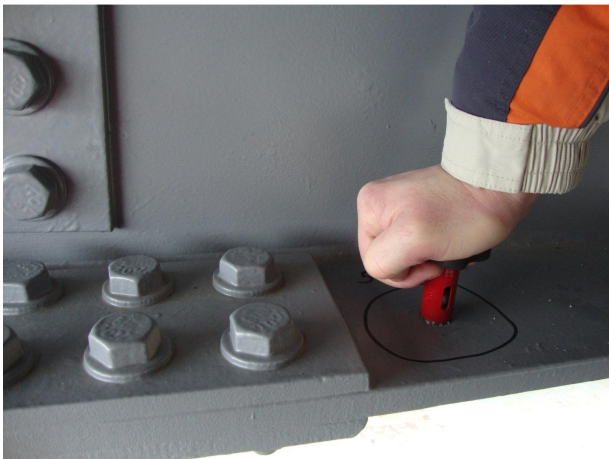
Рисунок 7.11. – Сквозное прорезание покрытия до металла.
